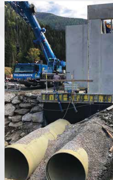
Die beiden Unterwasserkanäle im Krafthaus
